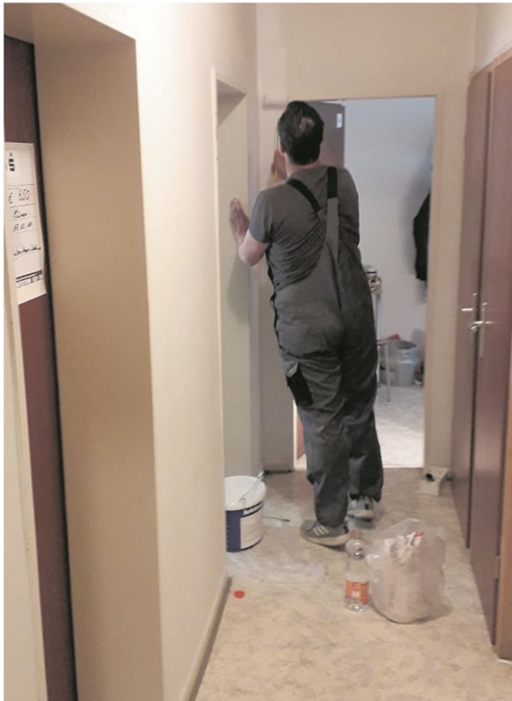
Der Wohnungslose Mark bei der Arbeit. Die Männer aus der Übernachtungsstelle wollen sich mit den Renovierungsarbeiten für die geänderten Öffnungszeiten in der schwierigen Corona-Zeit bedanken.
